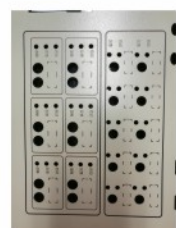
消防控制面板 Fire control panel
