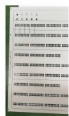
通讯机柜门 Communication cabinet door
